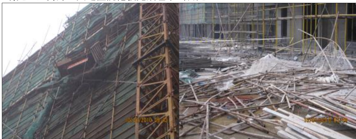
倾覆后的悬挑钢平台
