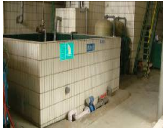
图四：污水排放池
